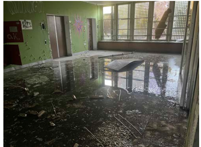
Abbildung 33: Wassereinwirkung Erdgeschoss Haus 701
