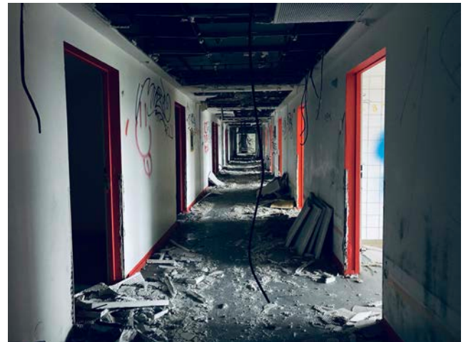
Abbildung 6: Flur im Gebäude mit zerstörten Decken und Wänden, Kabel die aus der Decke hängen (eigene Aufnahme)
