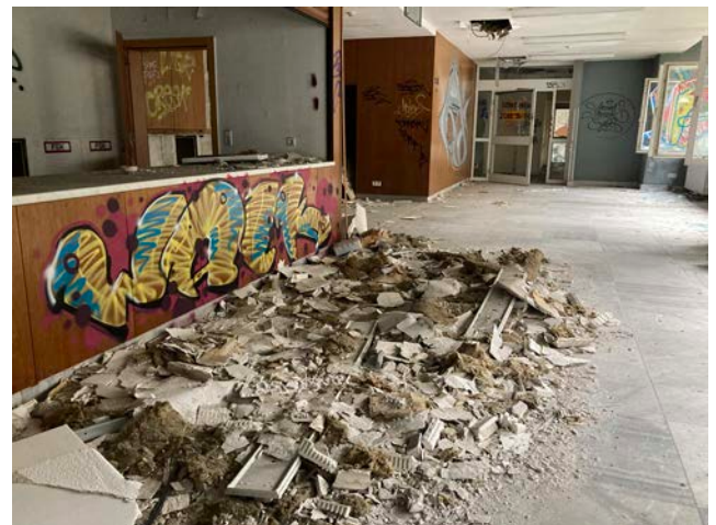
Abbildung 7: Vandalismusschäden in den ehem. Empfangsbereichen (eigene Aufnahme)
